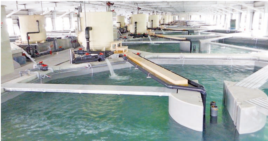
陸上養殖水質浄化システム
