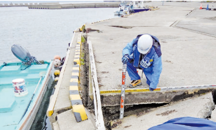
漁港機能診断(被災調査)
